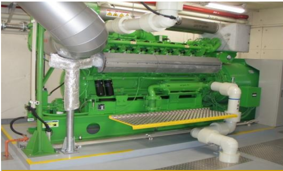
福岡市 中部水処理センター
