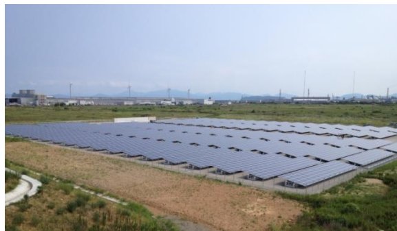
北九州市 市民太陽光発電所
