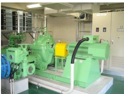
乙金浄水場 小水力発電所
